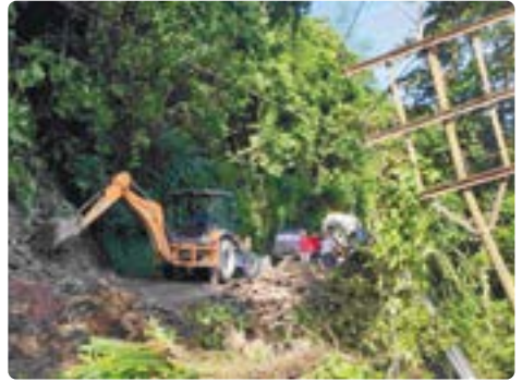
Schon bald wieder passierbar, allerdings nur mit halber Breite. Leitplanke und Strommast hängen in der Luft.
